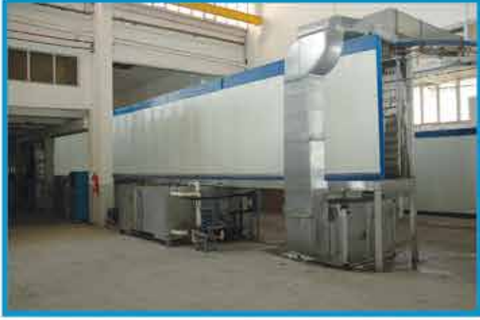
Sprey Tip Yüzey Temizleme Hattı Spraying Type Surface Pretreatment Line
