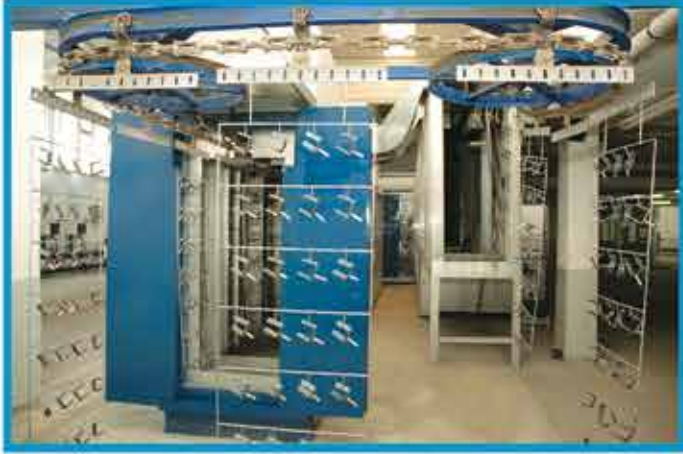
Sprey Tip Yüzey Temizleme Hattı Kuruma Fırını Spraying Type Surface Pretreatment Line and Curing Oven
